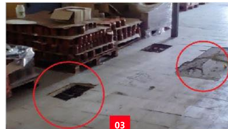
Нарушение целостности напольного покрытия
