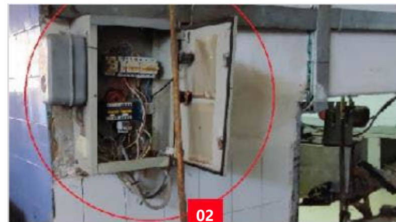
Металлический предмет у открытого электрического щитка
