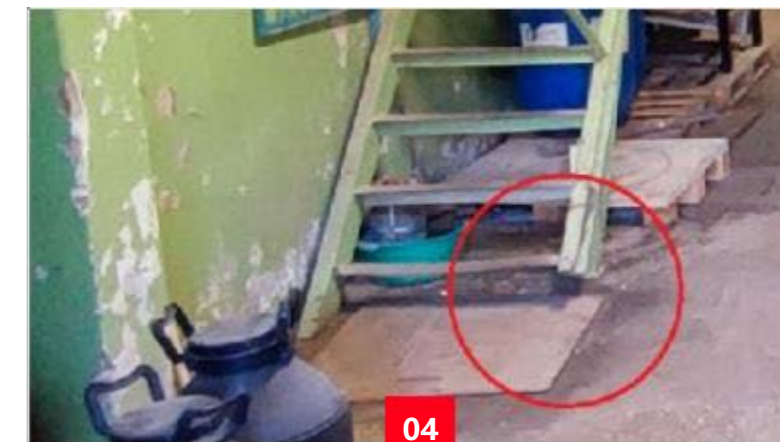
Отсутствие опоры лестницы
