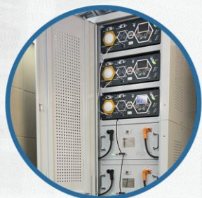
СИСТЕМЫ НАКОПЛЕНИЯ ЭЛЕКТРОЭНЕРГИИ
